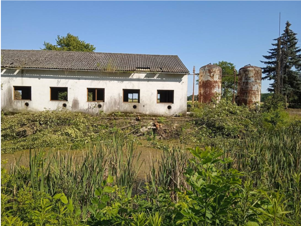
A meglévő telephely szivattyúháza és egyéb létesítményei a Tordosa-csatorna töltése felől (előtérben a meglévő vízkivételi medence) (EOV 503451/253769)
