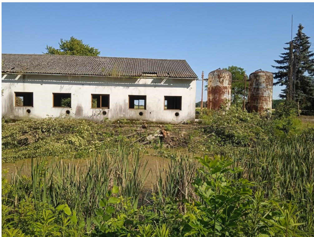
A meglévő telephely szivattyúháza és egyéb létesítményei a Tordosa-csatorna töltése felől (előtérben a meglévő vízkivételi medence) (EOV 503451/253769)
